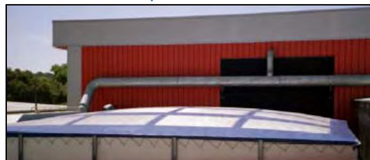
Couverture d'un biofiltre
