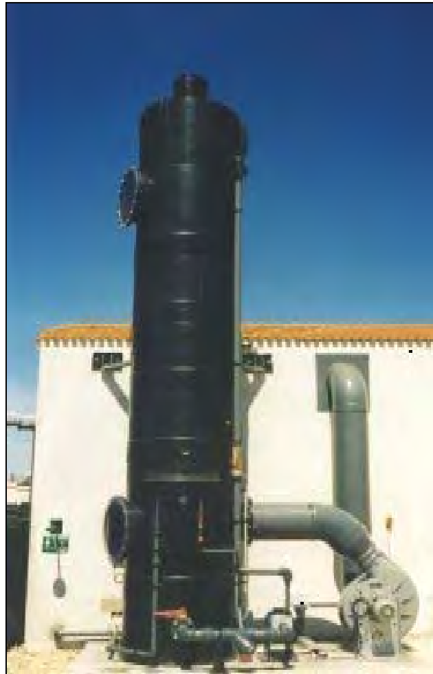
Tour de lavage acide
